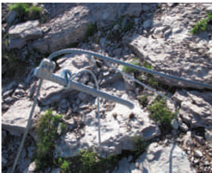
Fittoni da cresta (diametro 30 mm) e barre di controvento demoliti sulla via ferrata del M. Peller a causa dell'eccellente carico da neve dell'inverno 2013-2014
